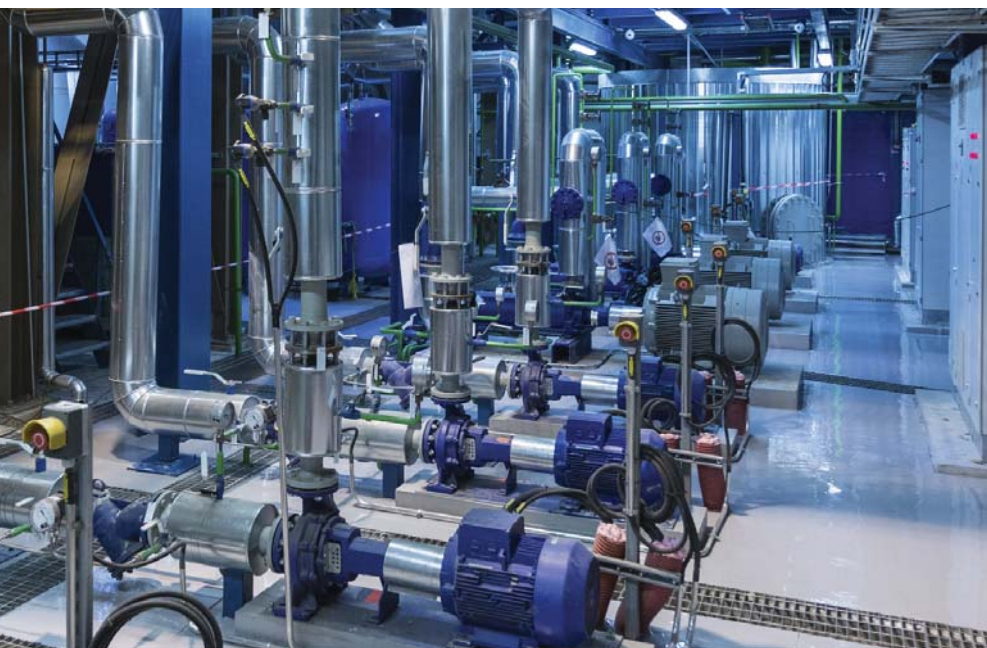
Stazioni di pompaggio nel settore building Automation dove si possono ottenere notevoli vantaggi con l'uso di inverter FR-F800
